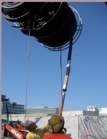
Die Erdwärmesonden werden als «resistant to crack» bezeichnet und sind jeweils 225 Meter lang. Die wärmetransportierende Sole zirkuliert in einem geschlossenen Kreislauf.
